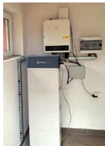
W Leśnictwie i Szkółce Leśnej Nowa Wieś, na terenie Nadleśnictwa Solec Kujawski, 8 września 2023 roku miał miejsce odbiór pierwszej w Lasach Państwowych instalacji fotowoltaicznej oraz magazynu energii typu off-grid
